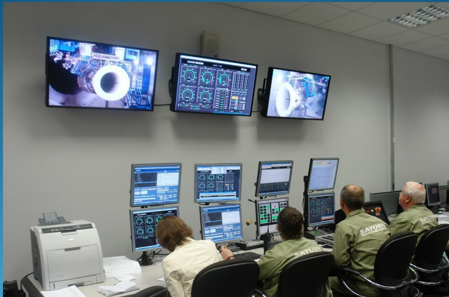
Пульт контроля и управления
