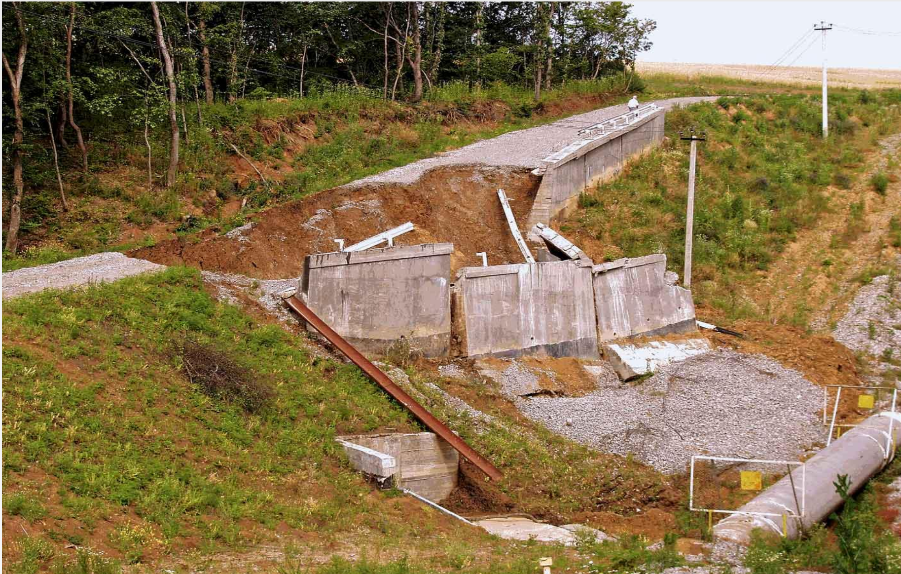
Обрушение подпорной стенки эксплуатационной дороги газопровода "Россия-Турция" (в районе ст.Северской)
