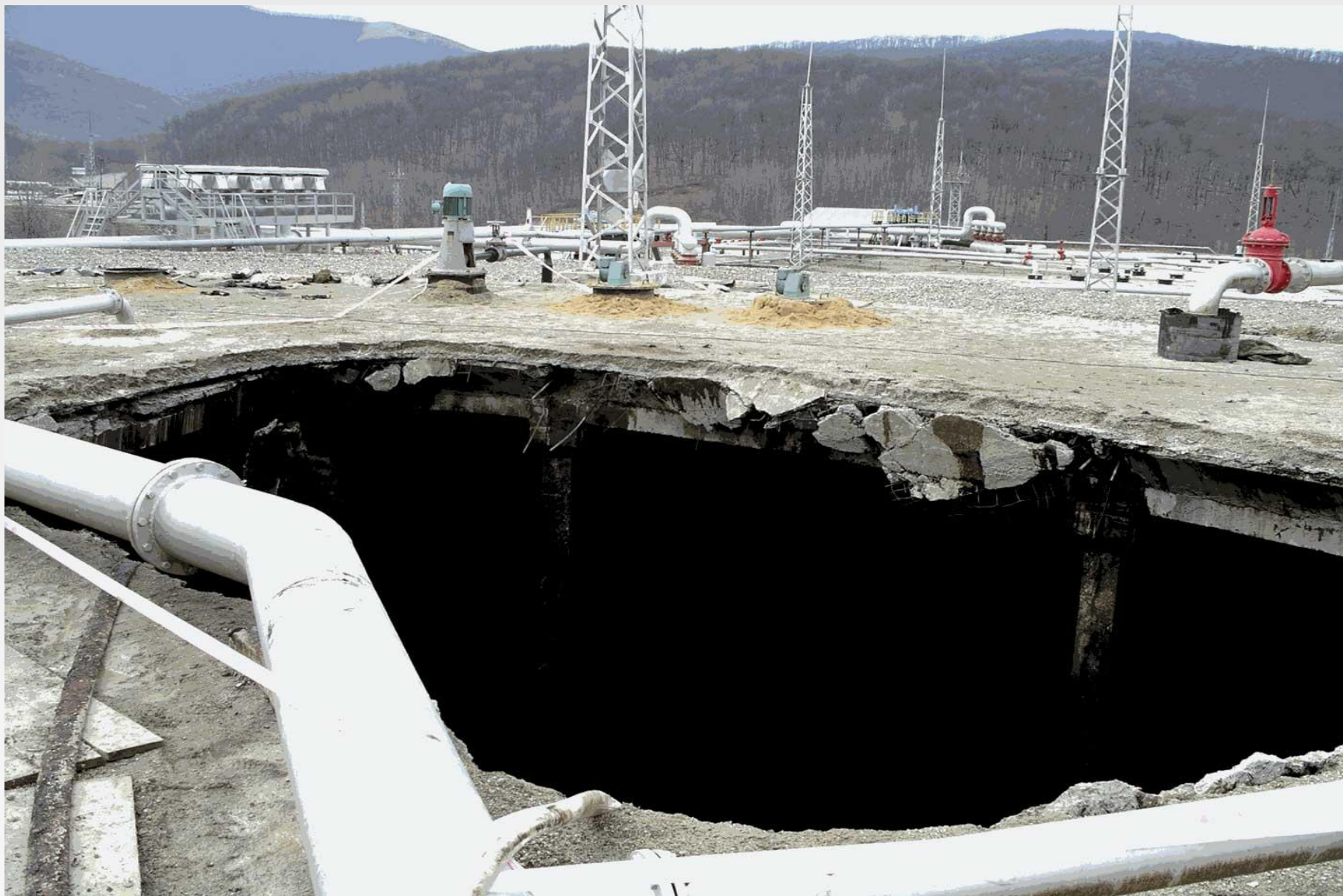
Обрушение крыши железобетонного подземного резервуара №49 емкостью 10000м3 на ПНБ "Грушовая" ОАО "Черномортранснефть"
