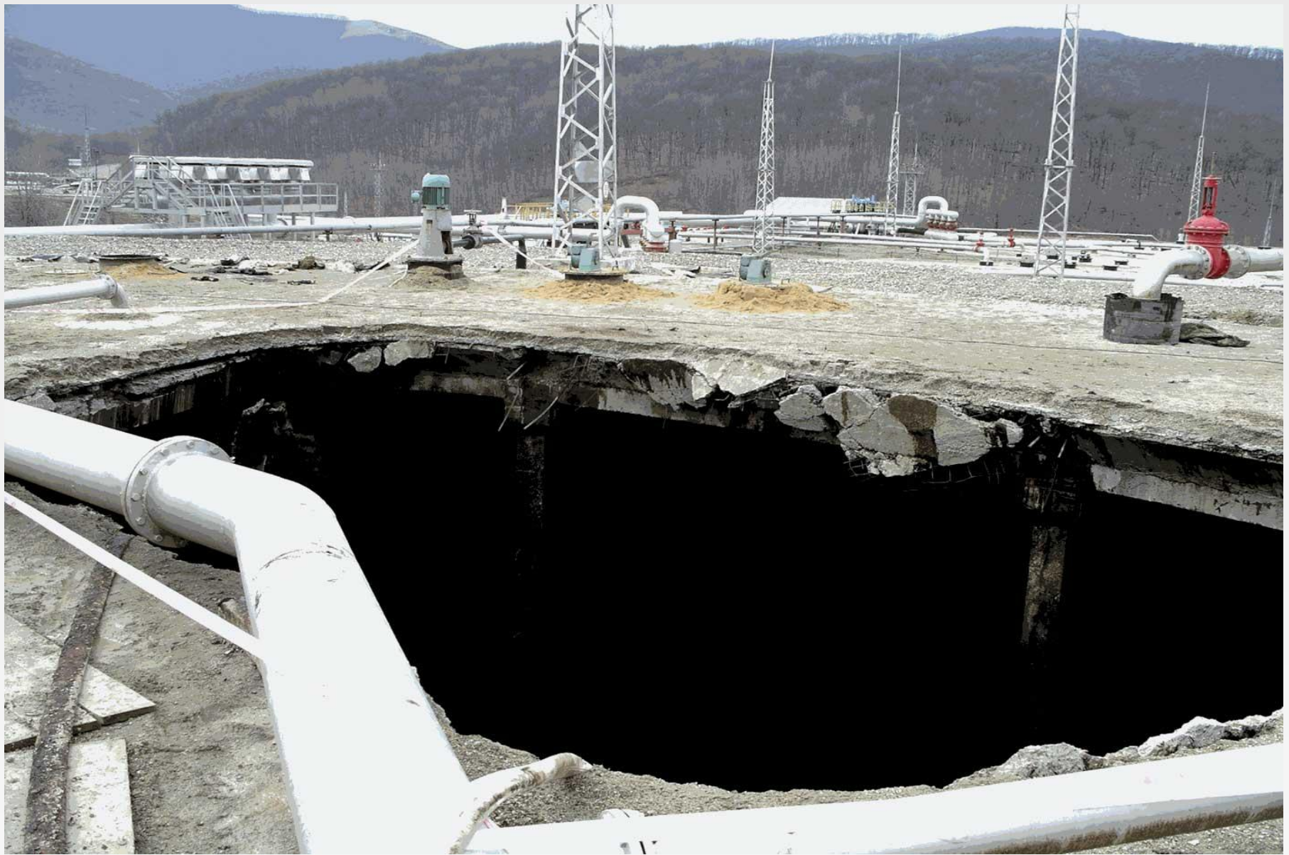
Обрушение крыши железобетонного подземного резервуара №49 емкостью 10000м3 на ПНБ "Грушовая" ОАО "Черномортранснефть"
