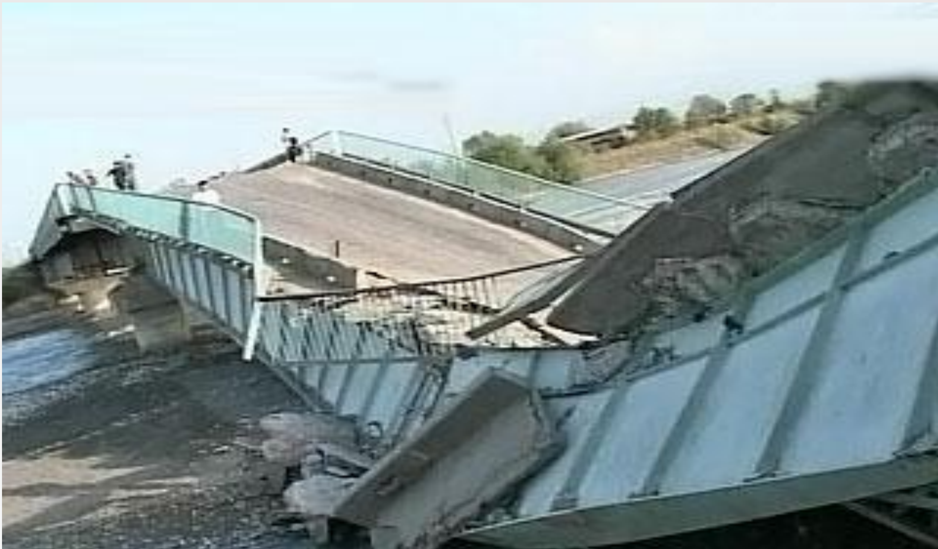
Хакасия, 08 сентября 2008, 13:49 — На федеральной трассе "Кавказ" рухнул мост через реку Аргун (постройки 1959 года)
