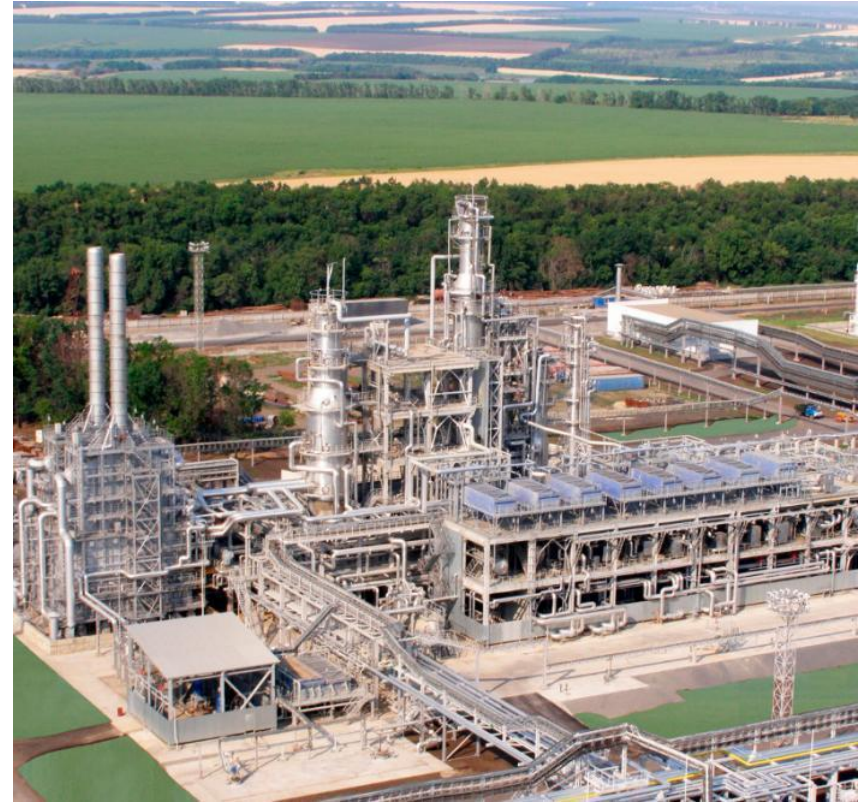
Общий вид установки первичной переработки нефти
