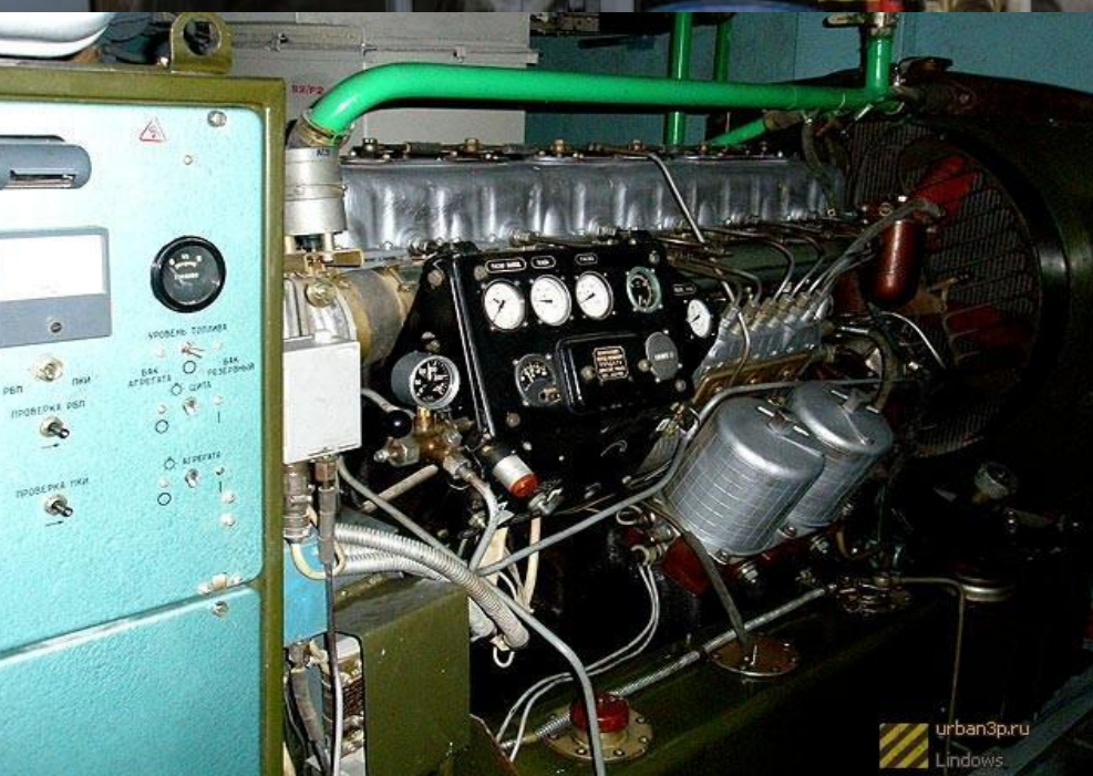
Дизельная электростанция (ДЭС).
