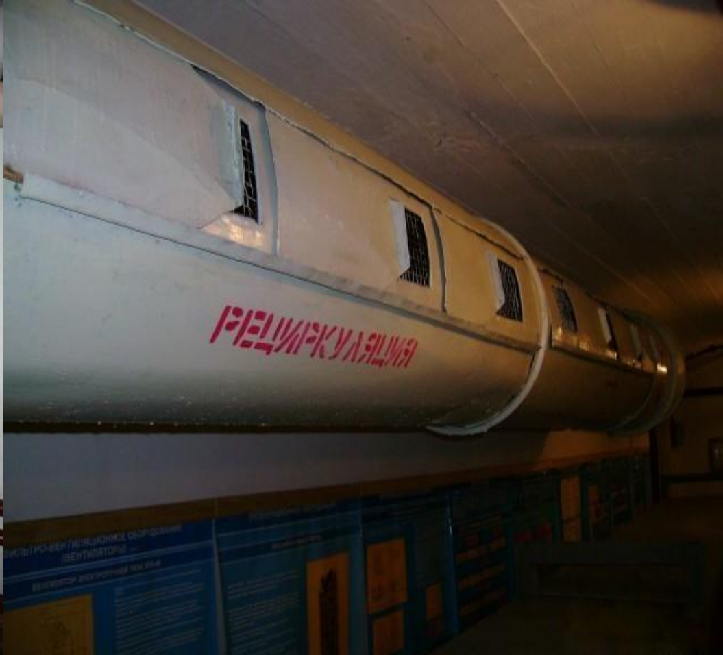
Выпускные отверстия на воздуховодах
