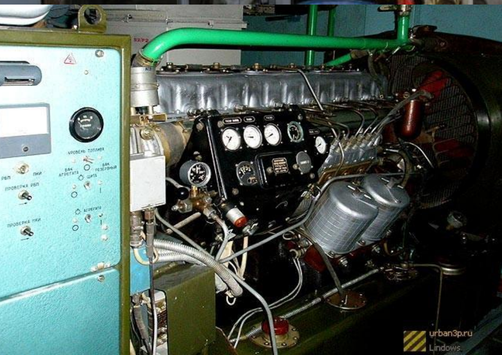
Дизельная электростанция (ДЭС).
