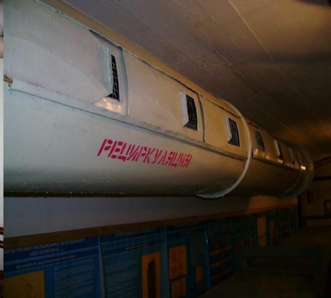
Выпускные отверстия на воздуховодах
