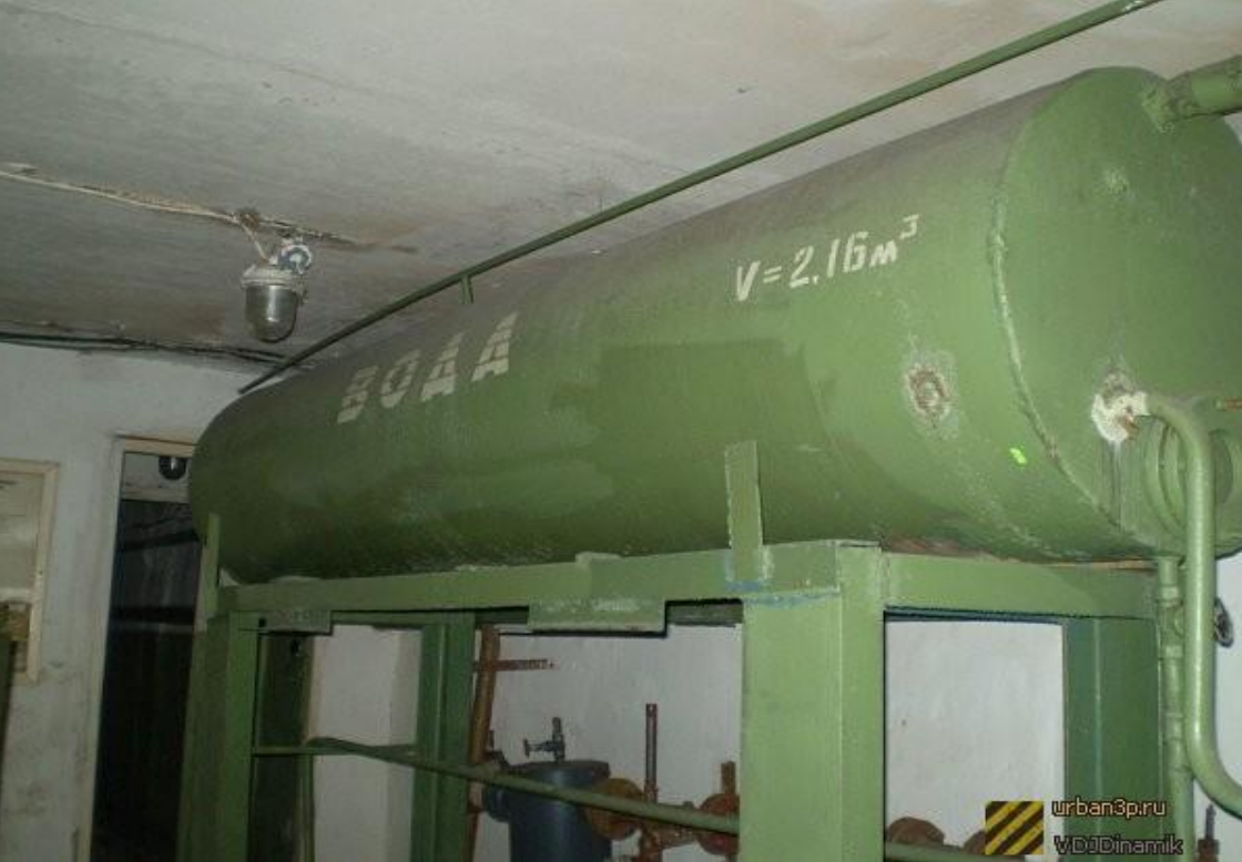
Бак аварийного запаса воды.
