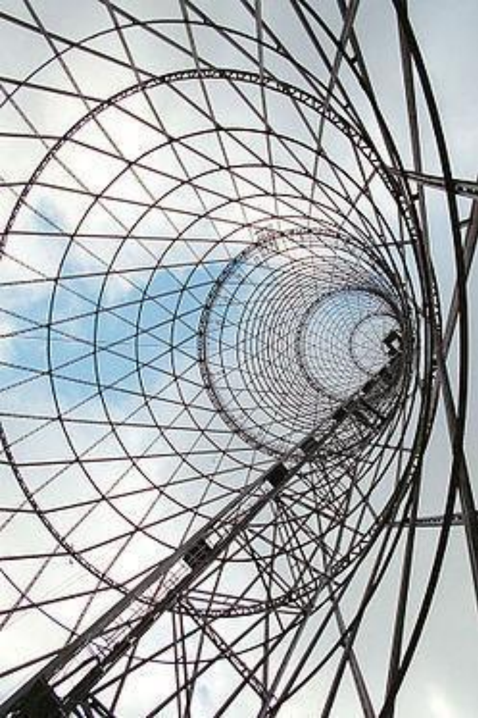
Шуховская башня (теле-радио башня на Шаболовке). 1922. Москва. Инженер В. Г. Шухов. Деталь конструкции
