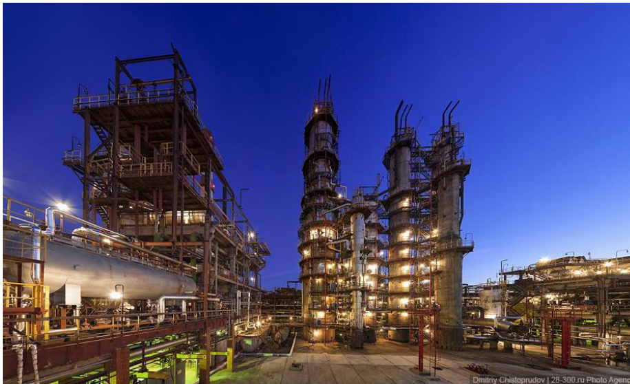
Внешний вид установки первичной переработки нефти на Московском НПЗ
