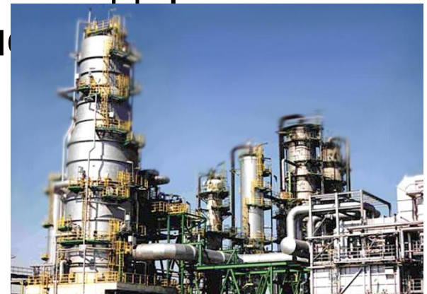
Внешний вид вакуумной трубчатой установки
