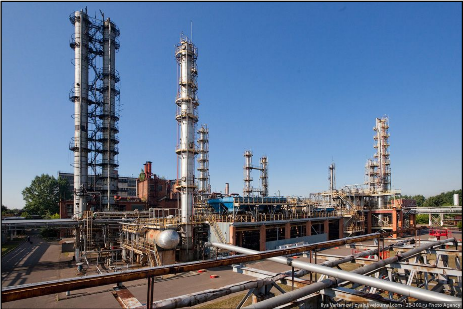
Рисунок 5. Технологическая Комбинированная установка по производству ТАМЭ ОАО «ГАЗПРОМНЕФТЬ-МНПЗ»
