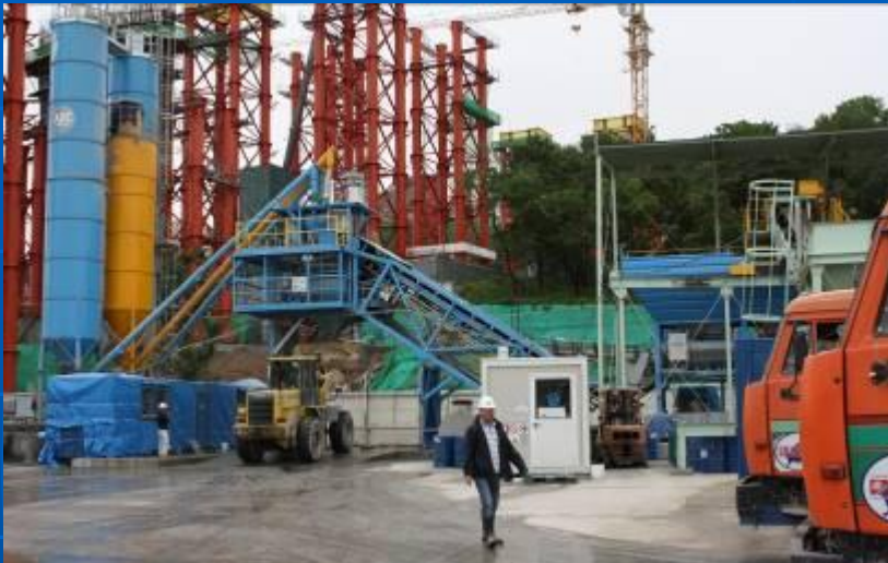
Стационарный бетонный завод
