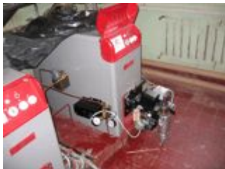
Горелка на отработанном масле EnergyLogic, установленная на котле Ferrolí
