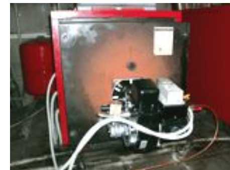
Горелка на отработанном масле EnergyLogic, установленная на котле Unical
