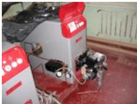
Горелка на отработанном масле EnergyLogic, установленная на котле Ferrolì
