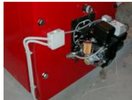
Горелка на отработанном масле EnergyLogic, установленная на котле Rosa
