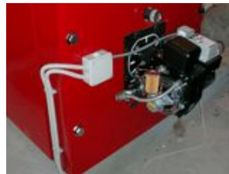
Горелка на отработанном масле EnergyLogic, установленная на котле Rosa
