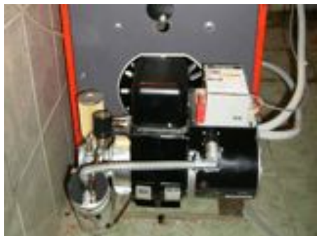
Горелка на отработанном масле EnergyLogic, установленная на котле ACV
