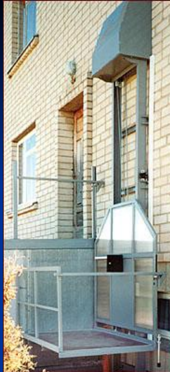
Вертикальный подъемник (открытого типа снаружи здания)
