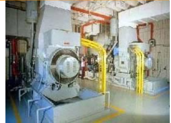
Газовые турбины (диапазон от 800 кВт до 10.5 МВт)
