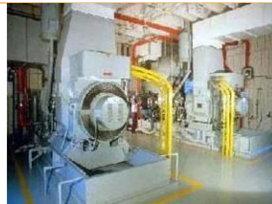
Газовые турбины (диапазон от 800 кВт до 10.5 МВт)
