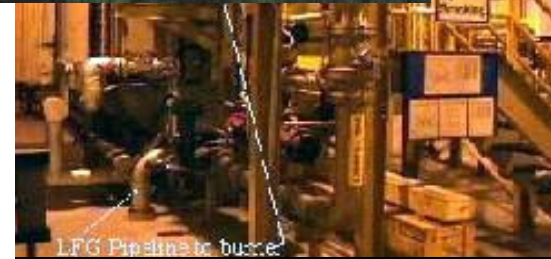
Котельная на Биогазе Ft. Wayne, IN
