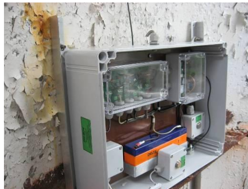
Корпус с оборудованием для GSM-шлюза и буферного аккумулятора
