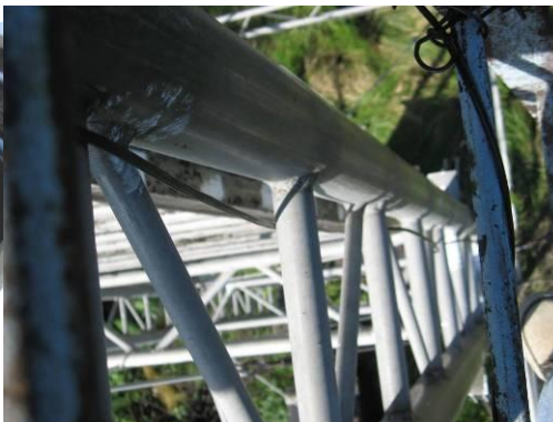
Кабель 1-Wire с верхней площадки проложен к основному извещателю РИТЭГ (25м)
