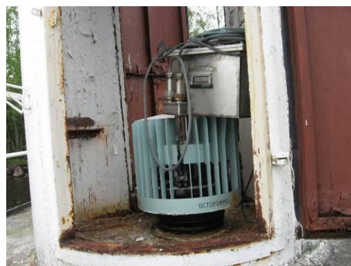
Внутреннее пространство (РИТЭГ и накопитель)
