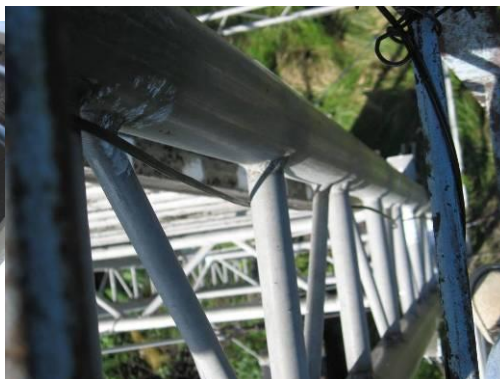
Кабель 1-Wire с верхней площадки проложен к основному извещателю РИТЭГ (25м)
