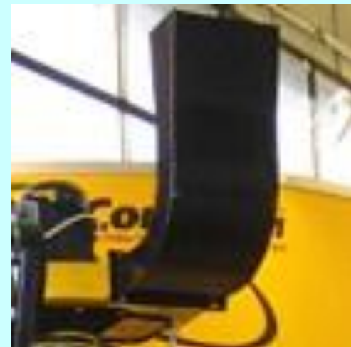
ТРУБОПРОВОД С ШУМОПОГЛАТИТЕЛЕМ
