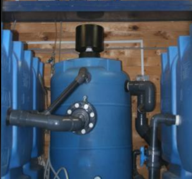
Установка глубокой очистки коммунальной сточной воды
