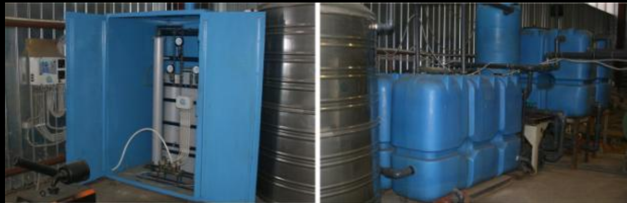
Установка глубокой очистки сточной воды полигона «ТИМОХОВО» по хранению твердых отходов.
