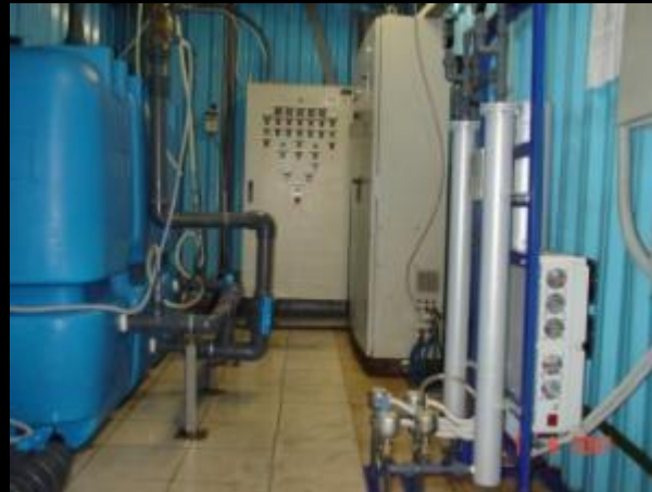
Система озонной очистки воды на линии розлива минеральной воды «Эдельвейс»
