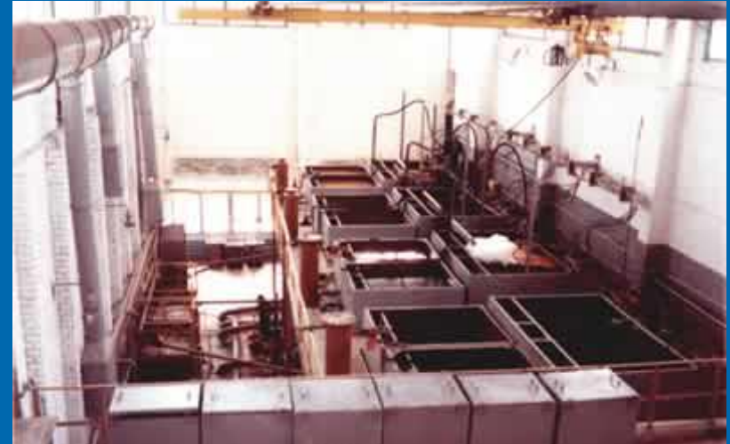
•Станция нейтрализации сточных вод
