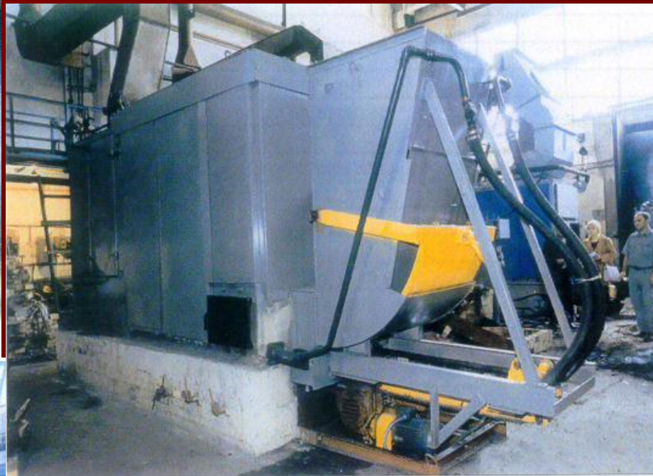
Котел 1,16 МВт (п. Алехино, г. Иркутск)
