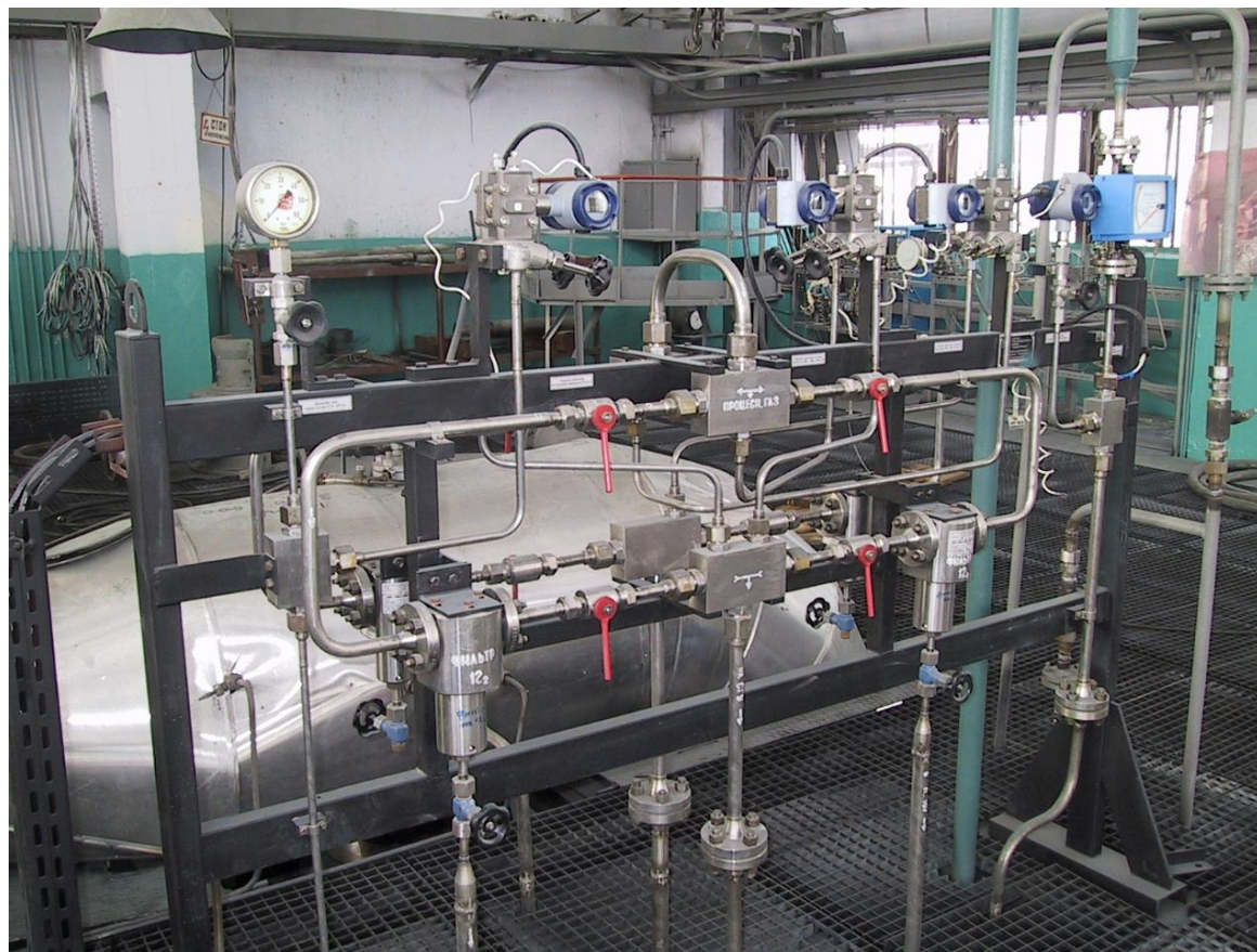
Панель управления «сухими» газовыми уплотнениями нагнетателя Н270-14-7
