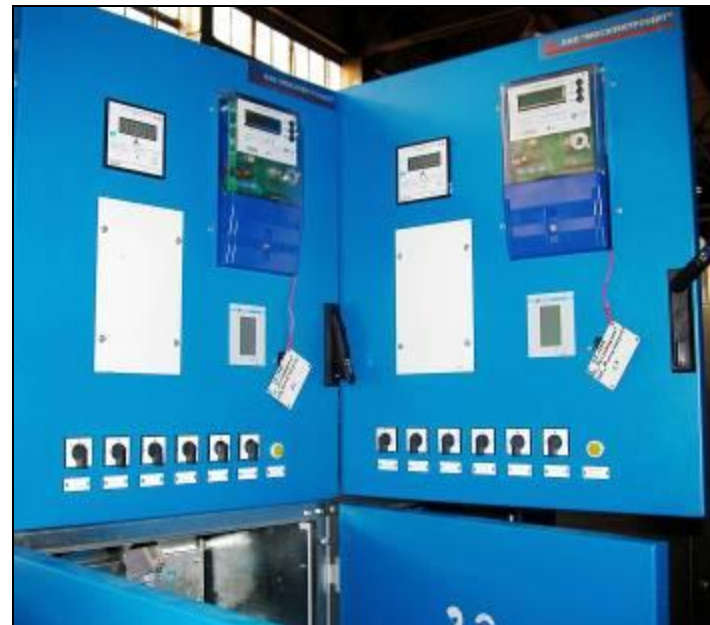
▲ Вид релейного шкафа снаружи
