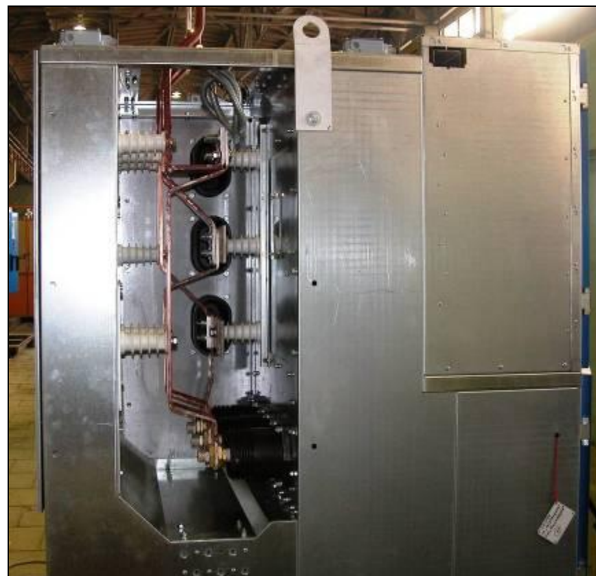
▼ Отсек сборных шин шкафа серии K-129
