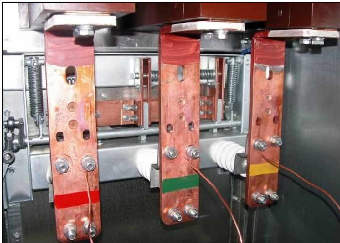
▲ Заземляющий разъединитель шкафа линии серии K-129. Сторона линейного отсека.
