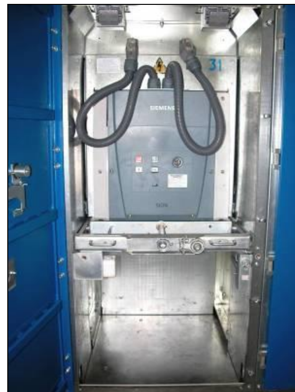
Отсек выключателя шкафа серии K-129 ►
