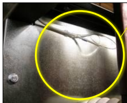
▶ Датчики в отсеке сборных шин
