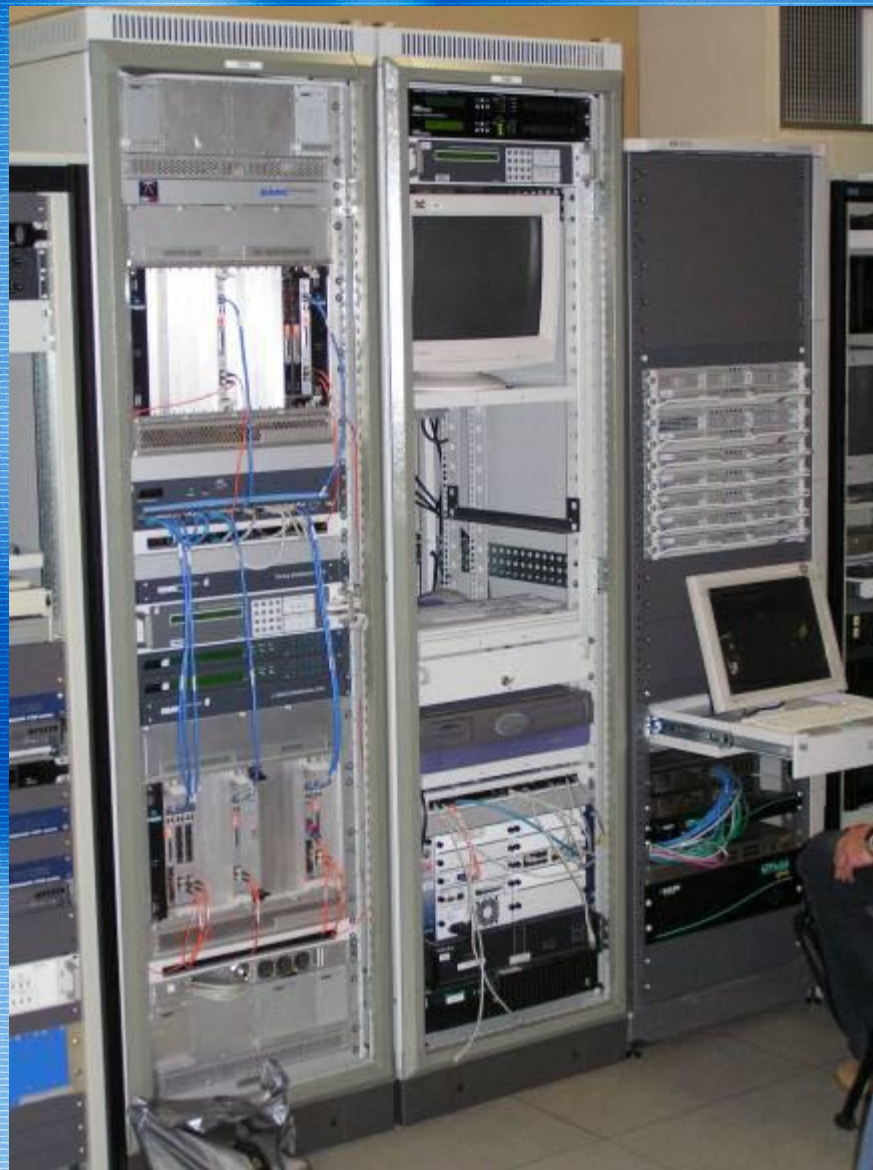
Стойки ГНУ «Вузтелекомцентр» в пос. Сколково
