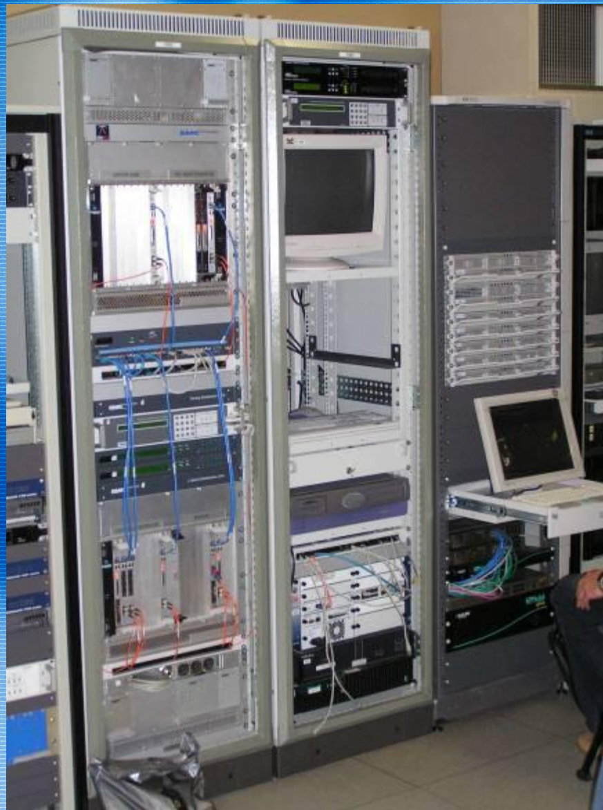
Стойки ГНУ «Вузтелекомцентр» в пос. Сколково
