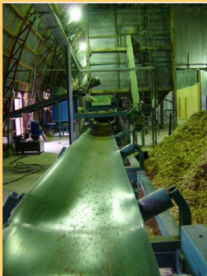
Ленточный транспортёр подачи в СРМ
