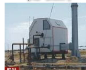
Печи подогрева нефти, теплообменники
