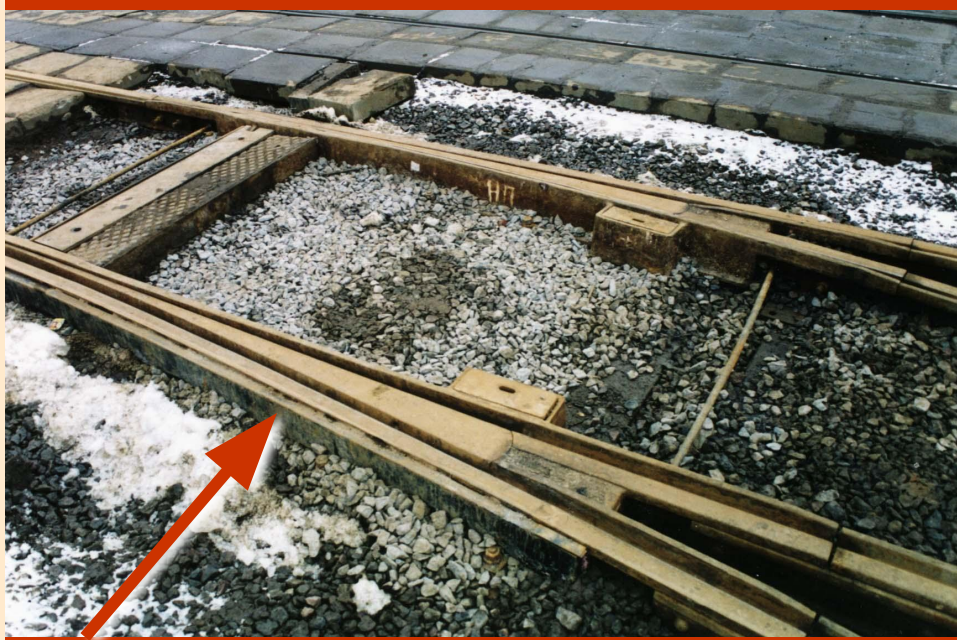
Нагреватель, смонтированный на стрелочном переводе
