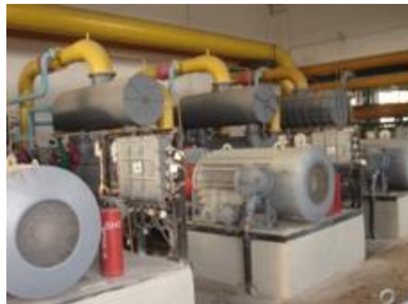
Рис.2. Вакуум-насосная станция (ВНС). Внутреннее помещение и вакуум-насос
