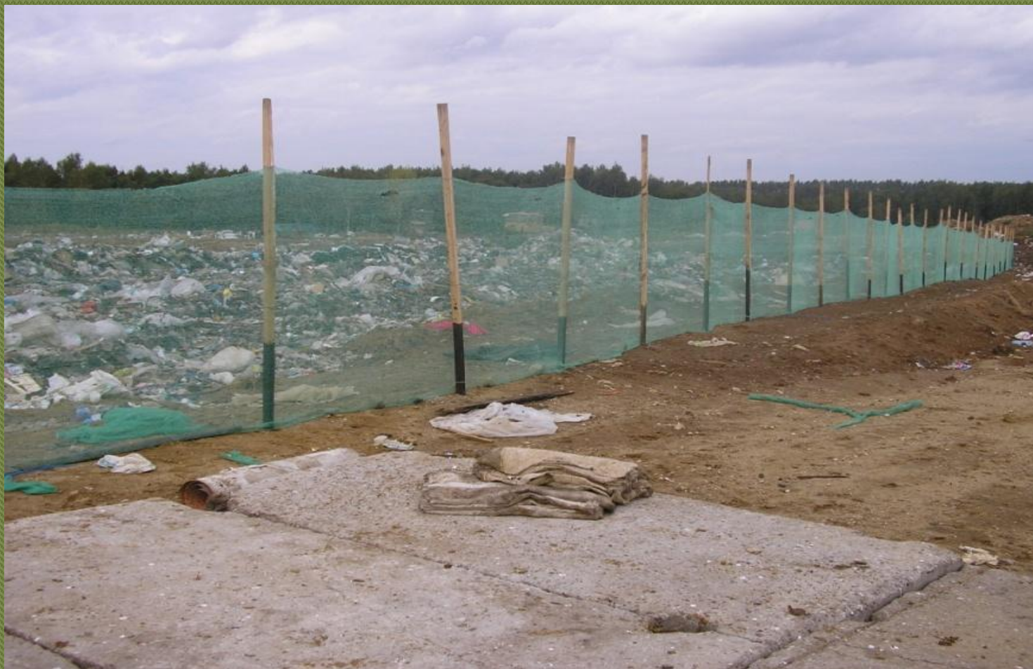
Защитно-улавливающая сетка на рекультивируемой свалке у с. Новоалександрово.
