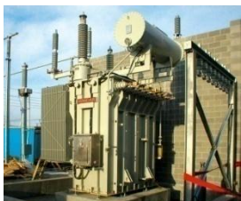
Однофазный конверторный трансформатор BESS GVEA 138/4x2.465 кВ, 14.9 МВА, США
