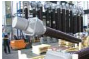
ИЗМЕРИТЕЛЬНЫЕ ТРАНСФОРМАТОРЫ 400 кВ ЭЛЕКТРОХОЗЯЙСТВО ГРЕЦИИ
