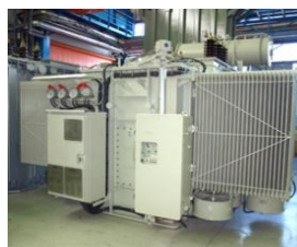
Трехфазный трансформатор ADWEA 33/11 кВ, 20 МВА АБУ ДАБИ
