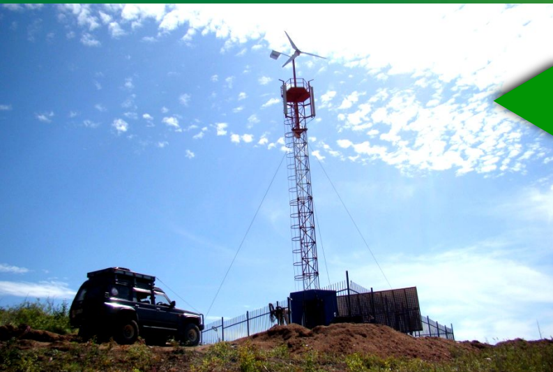
Солнечно-ветровая станция Колок (Бурятия)
