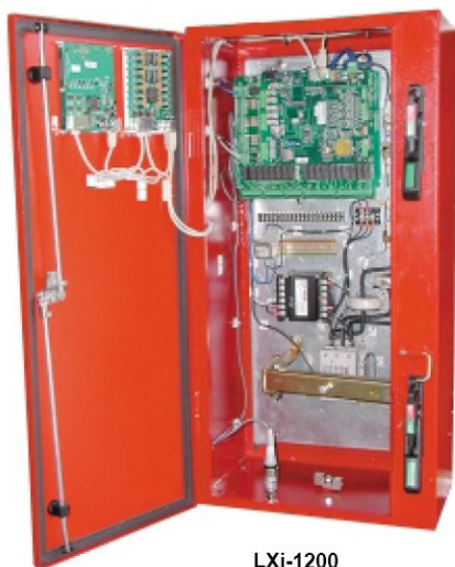
Станции управления насосами пожаротушения
