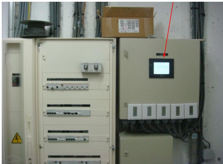
Внешний вид шкафа управления с панелью оператора
