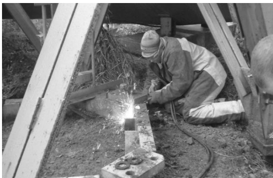
Устранение аварийных ситуаций на опорах
