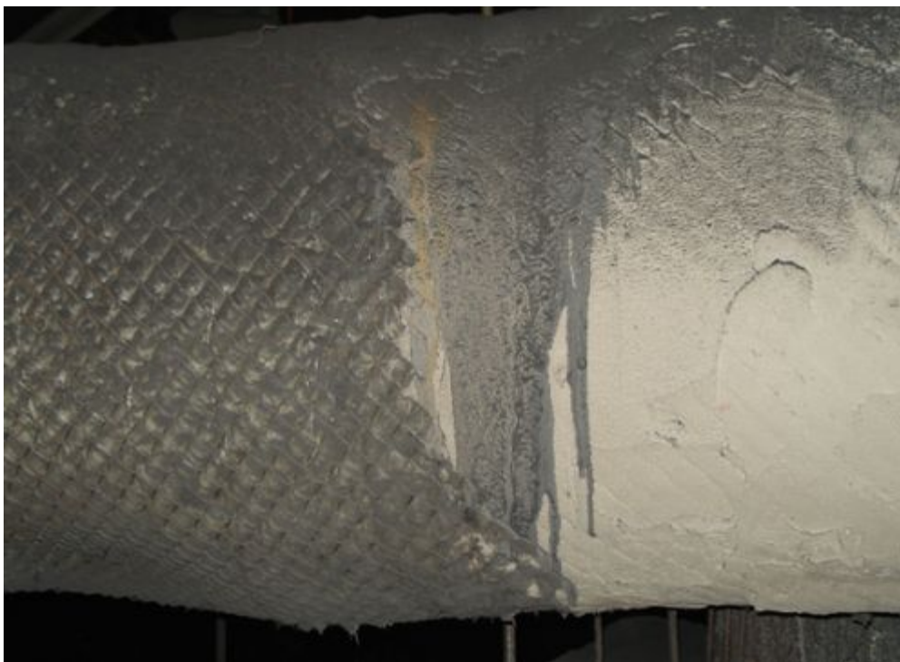
Теплоизоляция газохона на ТЭЦ
