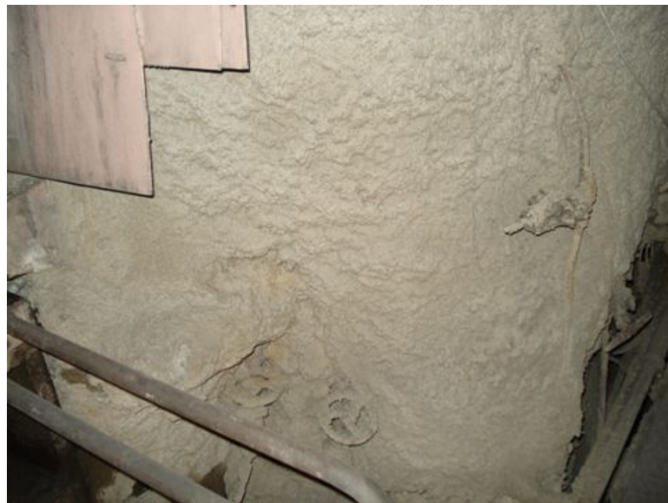
Теплоизоляция агрегата на ТЭЦ
