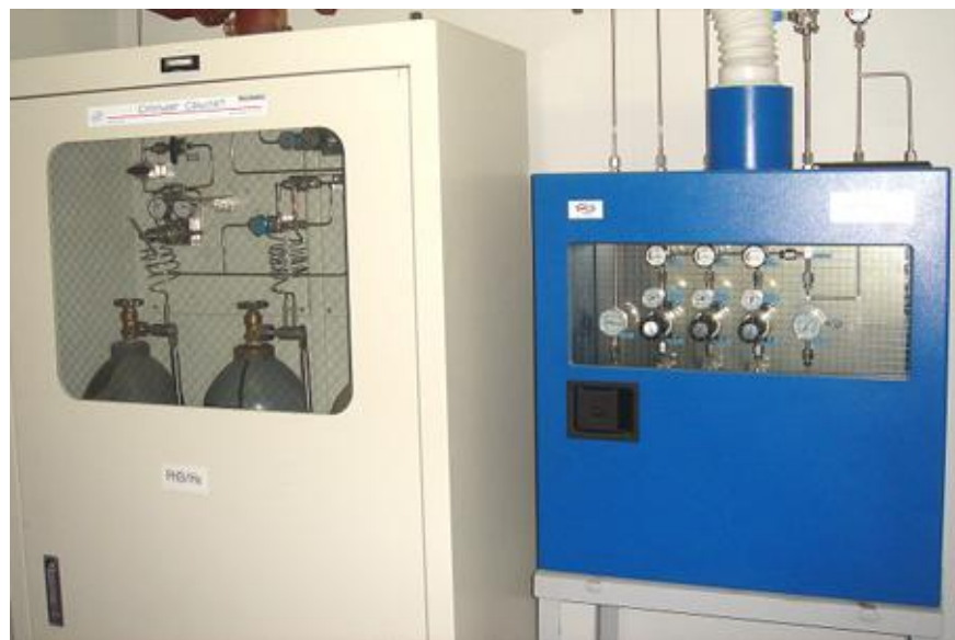
Газовый шкаф и панель для PH3
