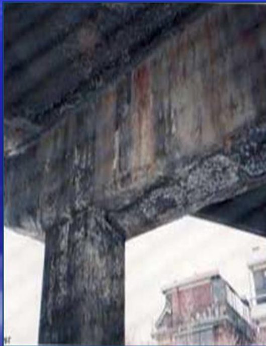
Ускорение коррозии металла
