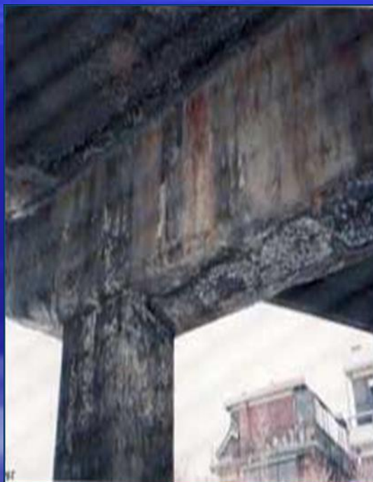
Ускорение коррозии металла
