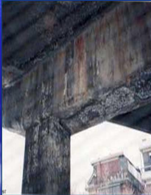
Ускорение коррозии металла
