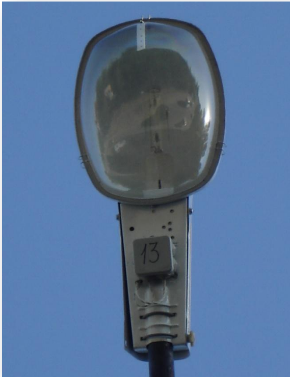
Светильник ЖКУ-150 «Пегас» с адресным управлением и внешним креплением приемника адресных команд.
