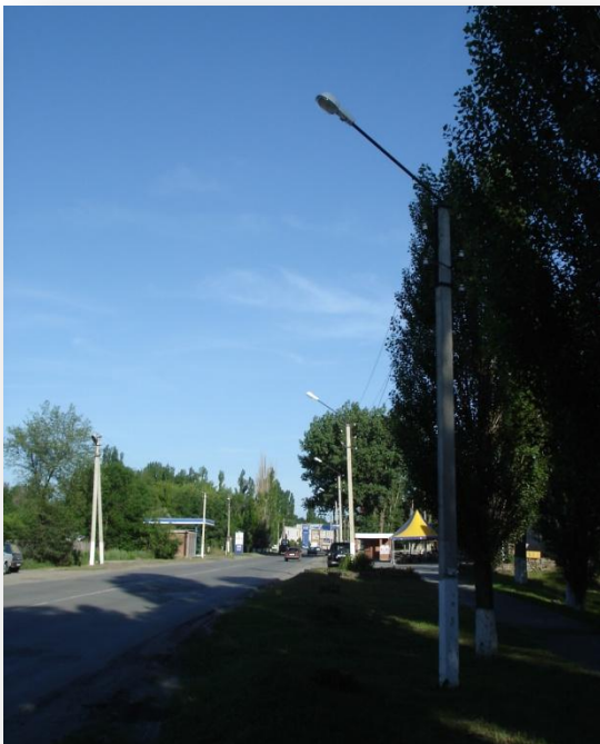
Система освещения. Районный центр Каменоломни. 15 светильников.
