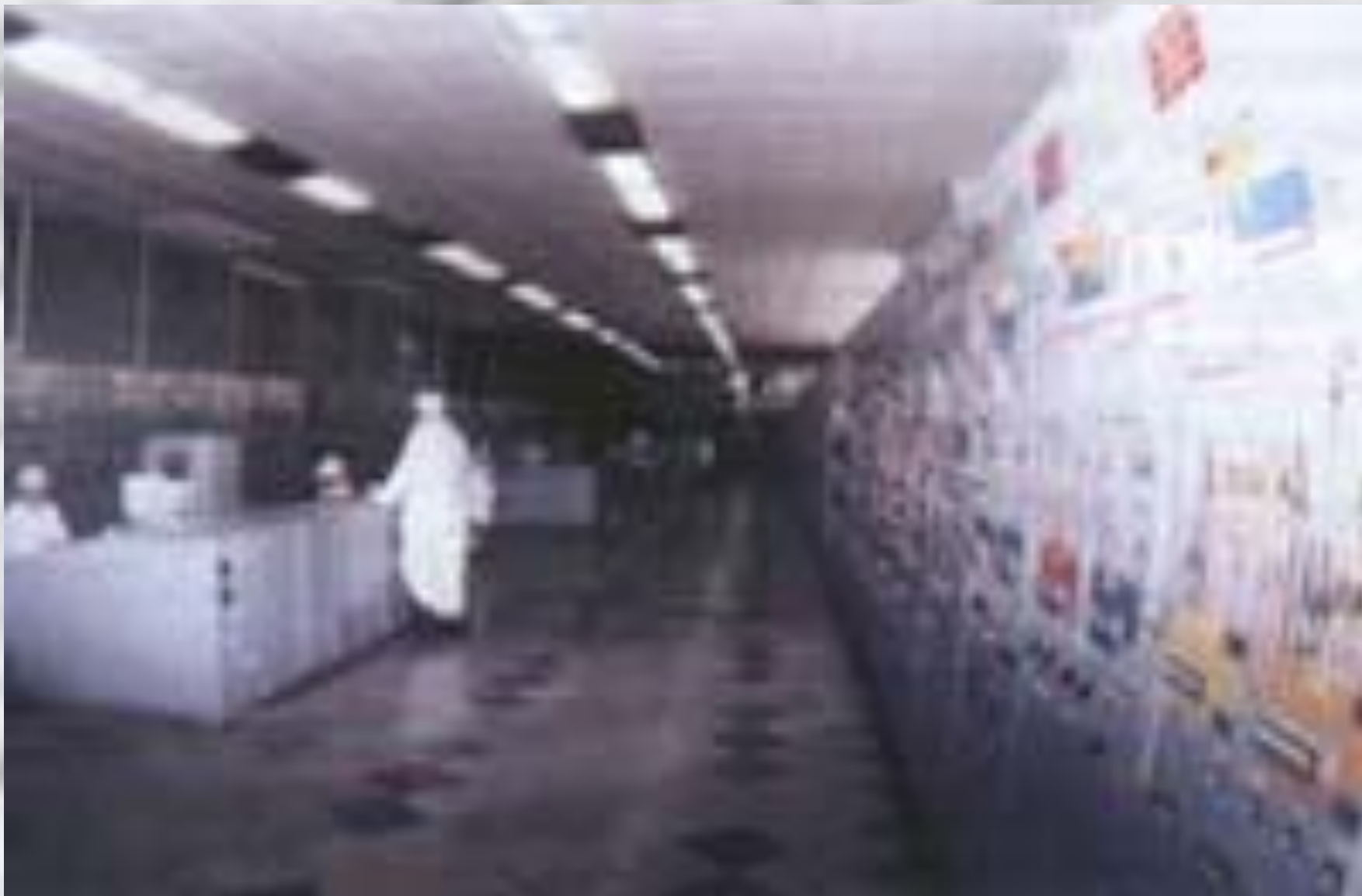
Рис.3. Пулы управления завода радиохимической переработки ОЯТ на ПО «Маяк»
