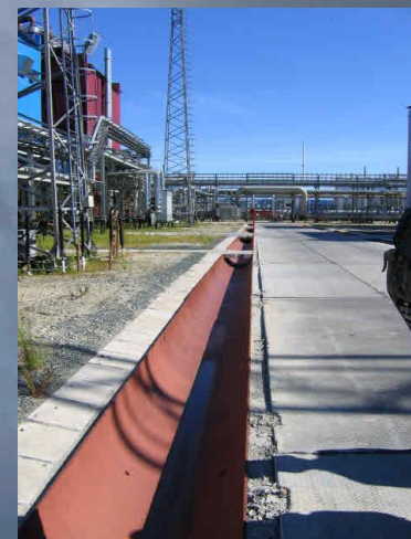
На ГП широко применяются системы отвода ливневых и паводковых вод
