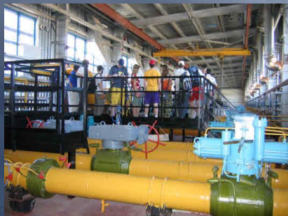
Дожимная компрессорная станция (ДКС)
