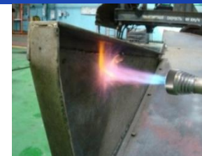
НАПЫЛЕНИЕ АНТИБАКТЕРИАЛЬНЫХ ПОКРЫТИЙ НА ОСНОВЕ СВМПЭ НА СТЕНЫ РЕЗЕРВУАРА МЕТОДОМ ГАЗОПЛАМЕННОГО НАПЫЛЕНИЯ
