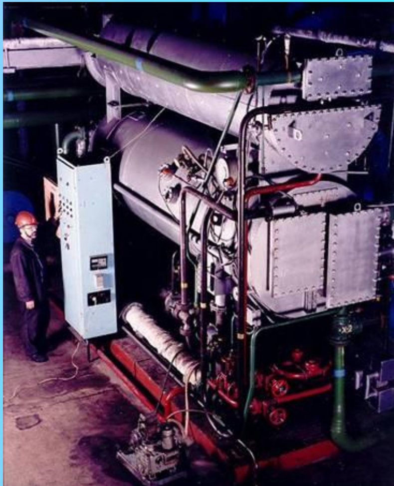
Абсорбционный тепловой насос АБТН-2000 (2 МВт) (ИТ СО РАН, «Теплосибмаш»)
