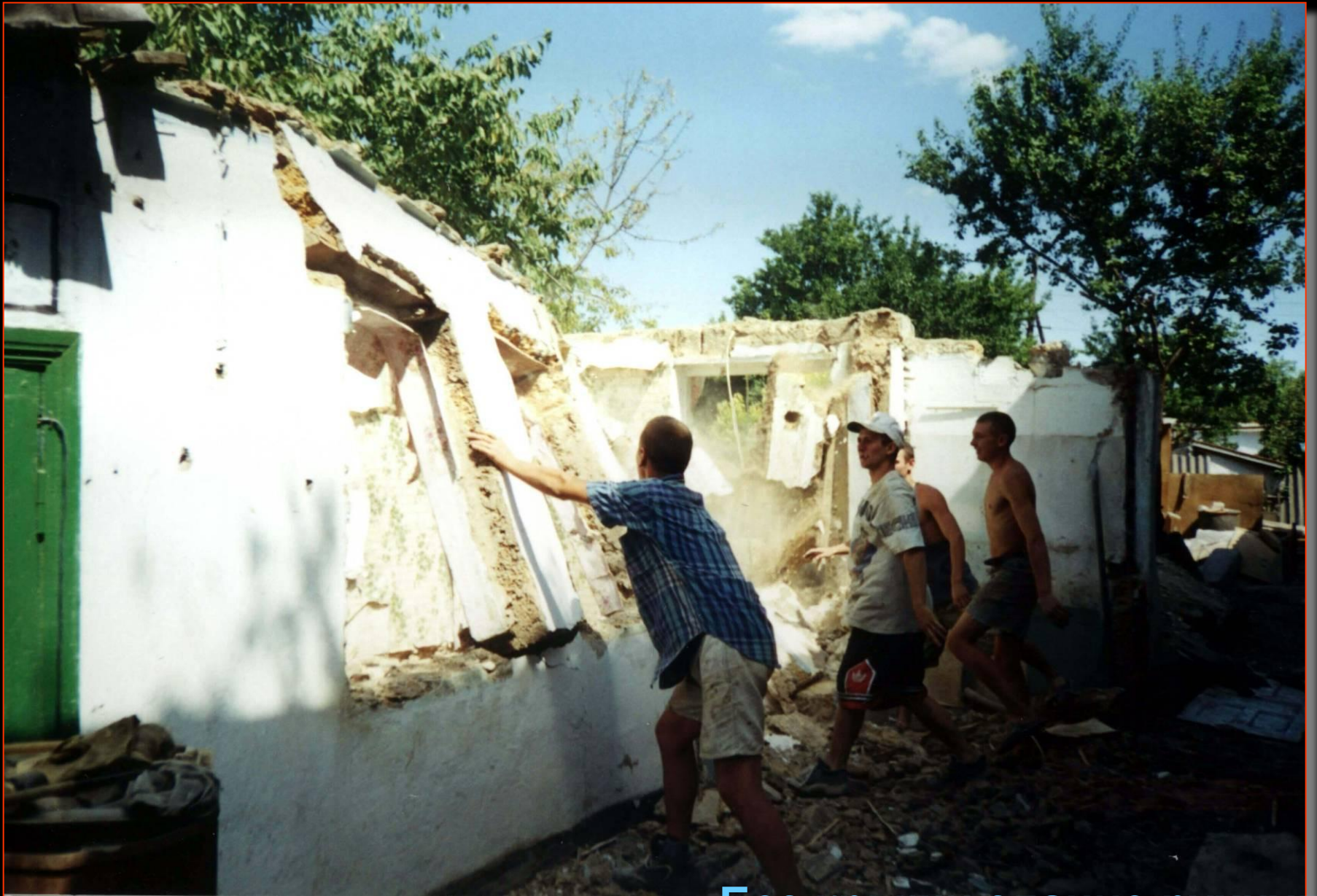
Без крыши здание рухнуло Без фундамента стены держались благодаря крыше
