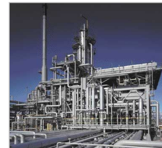
Установка изомеризации на зарубежном НПЗ. Площадка: 75 м × 50 м
