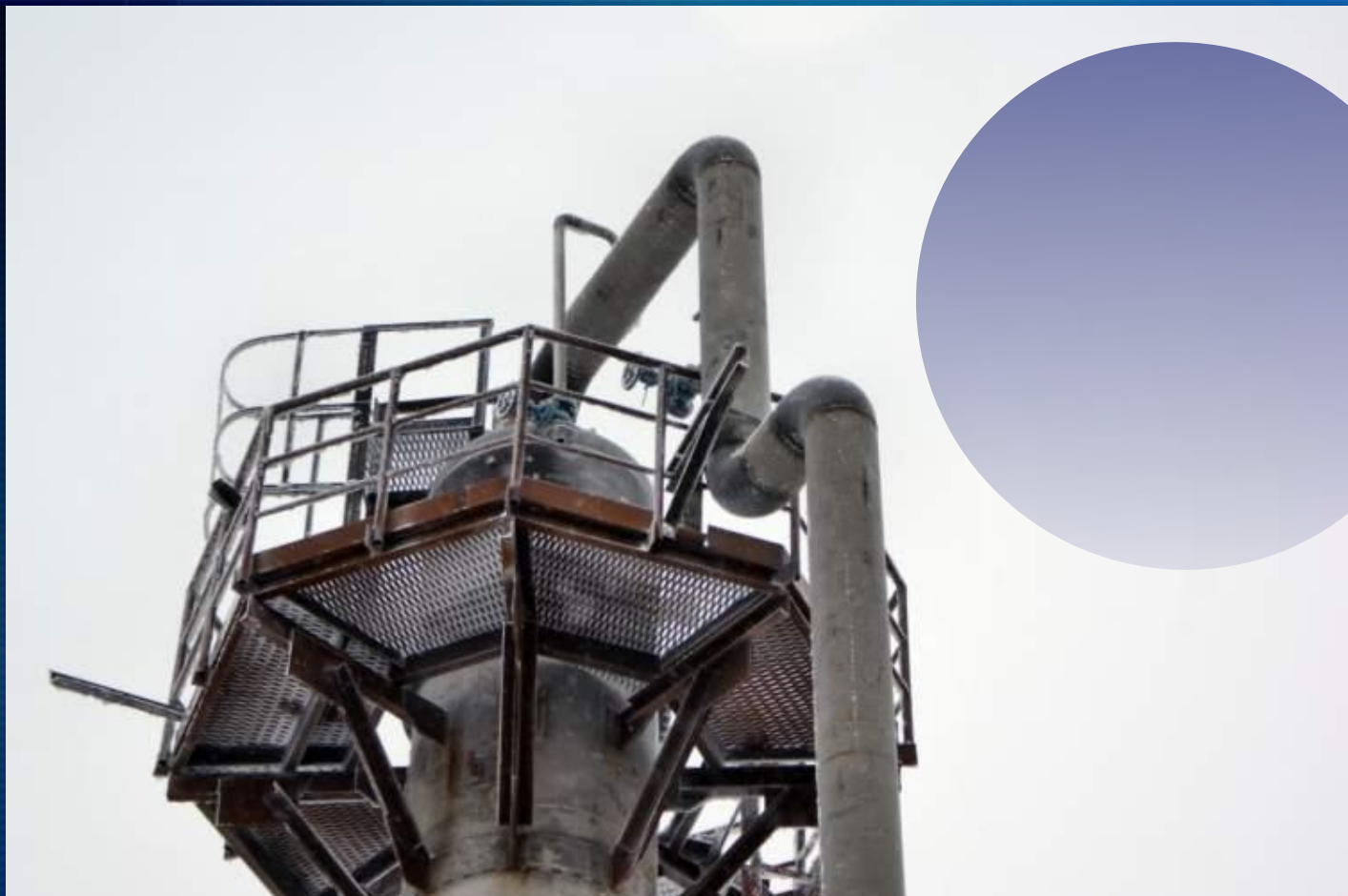
Колонна ректификации верхняя часть
