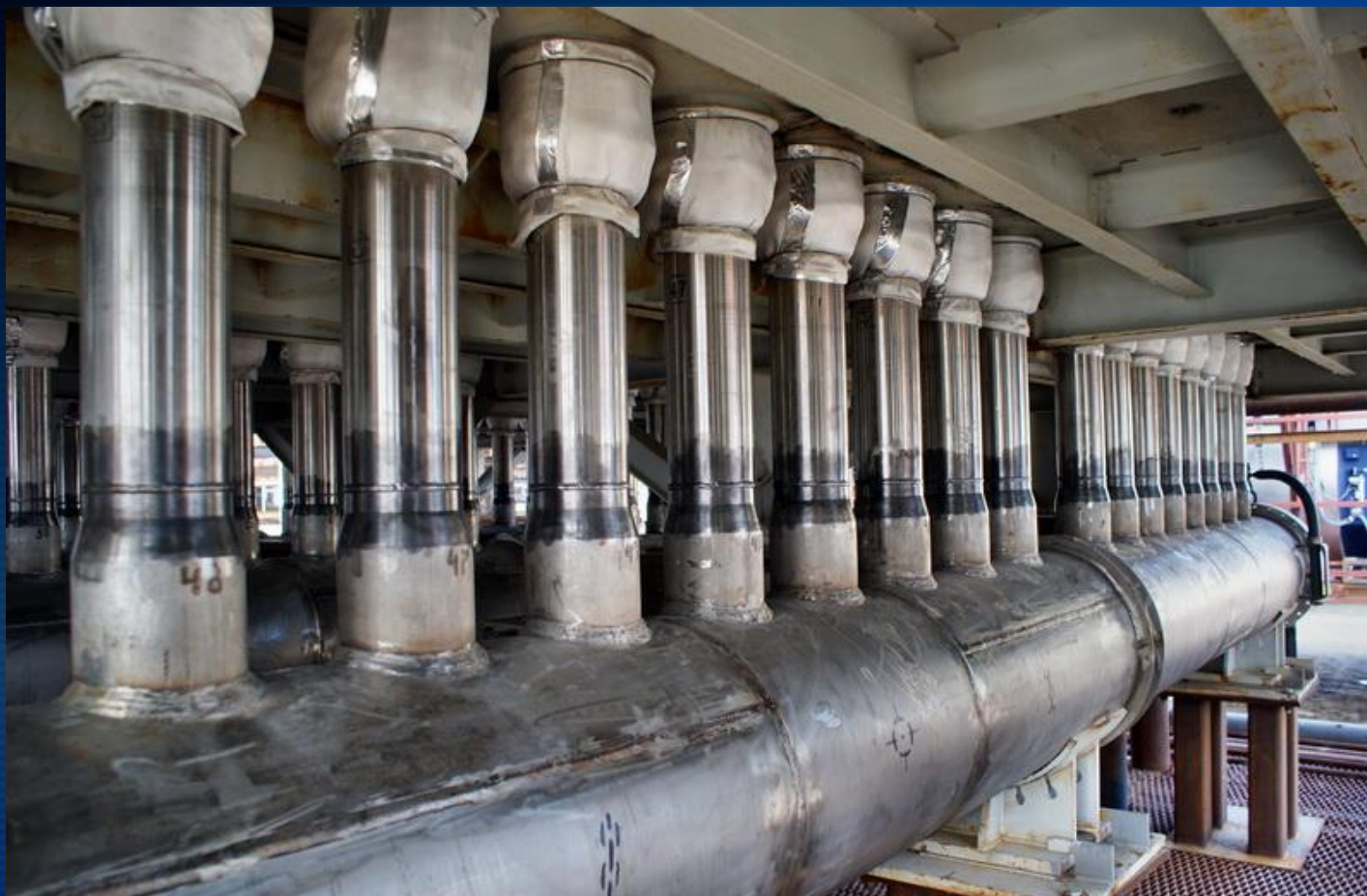
Вид нижнего коллектора конвертированного газа ППР-40.
