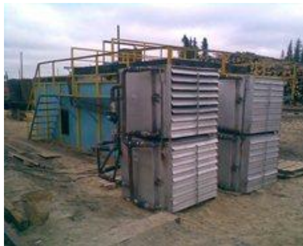
Установка МПРУ с тепловым узлом
