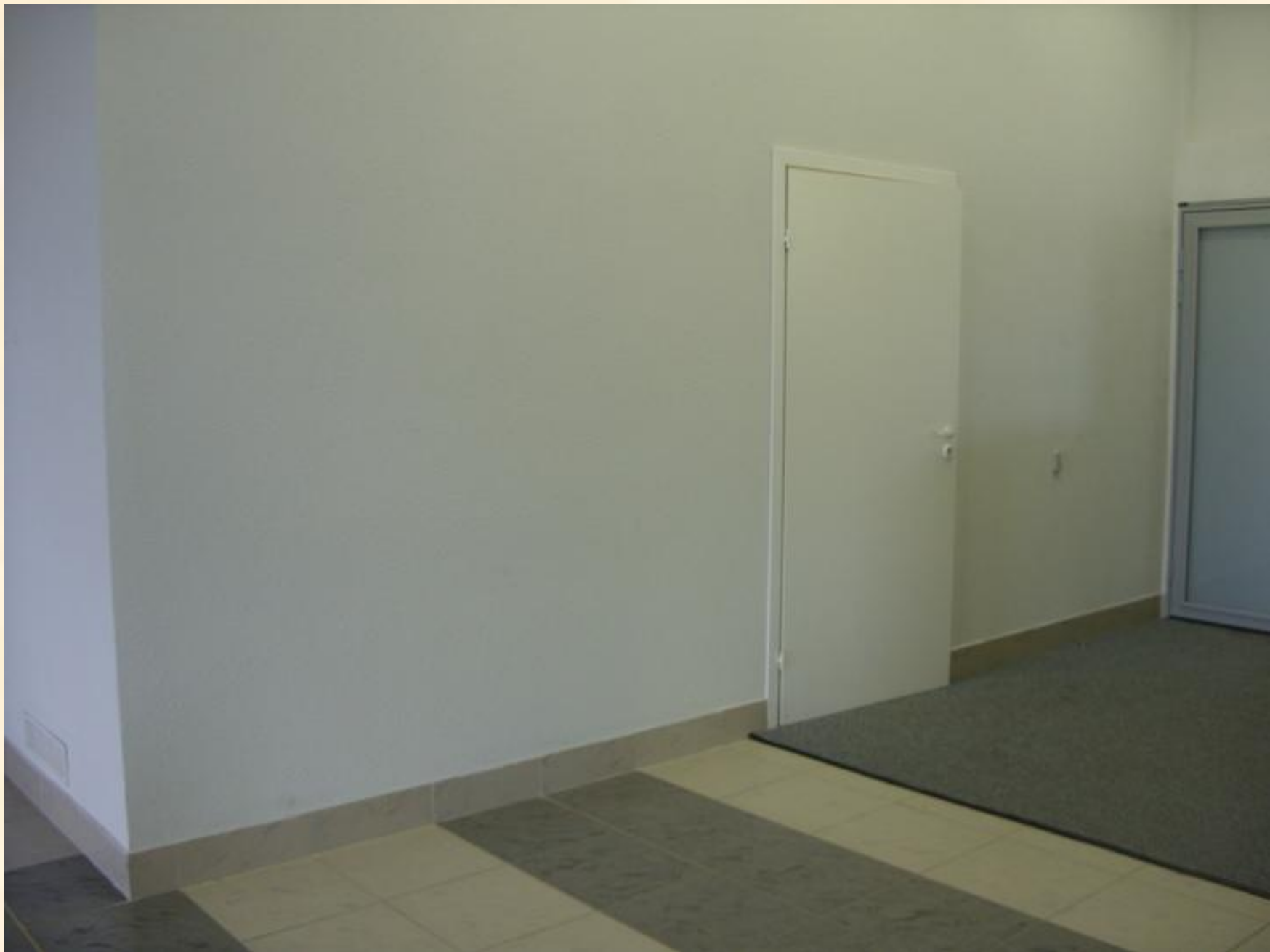
ПОМЕЩЕНИЕ ТЕПЛОВОГО УЗЛА
