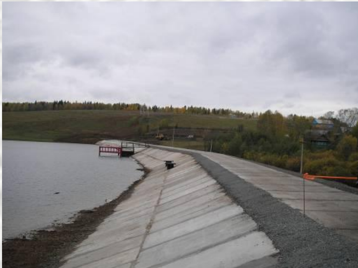
ГТС пруда на р.Троицкая в д.Ореховая Гора Чернушинского района (до и после капитального ремонта)
