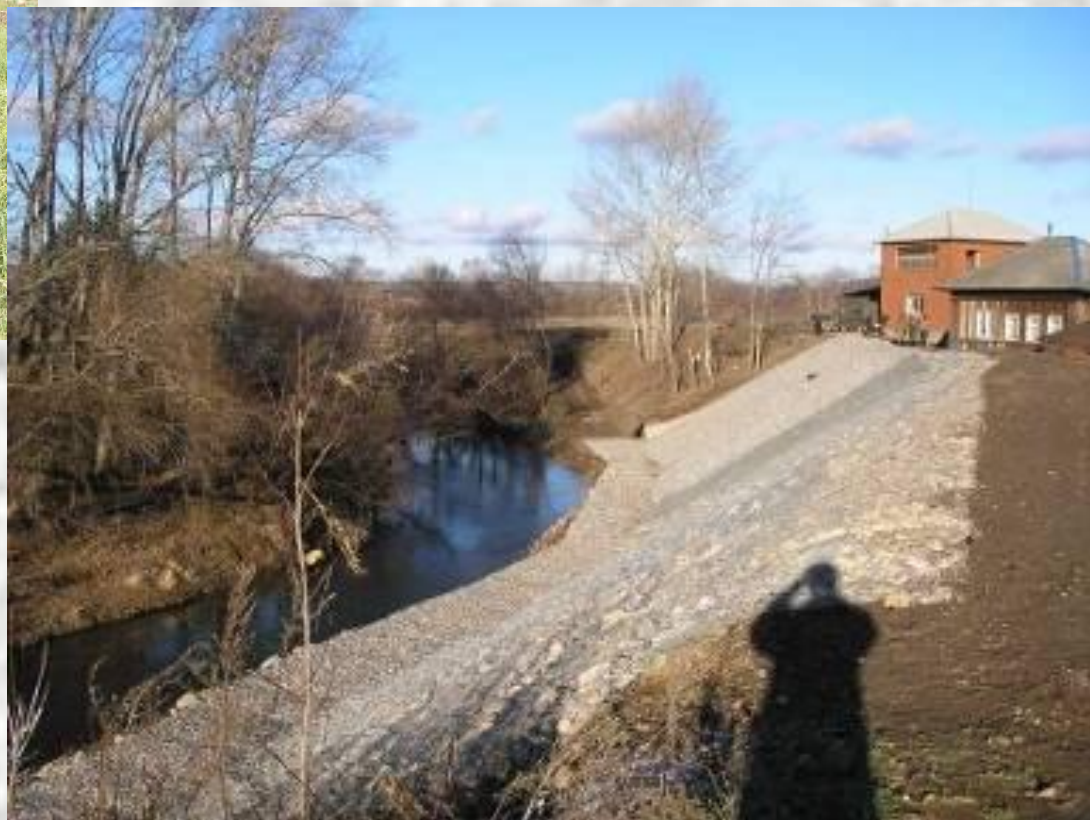
Участок дамбы на р.Шаква по ул. Плехановская, д. 2,11 в г.Кунгуре (до и после капитального ремонта)
