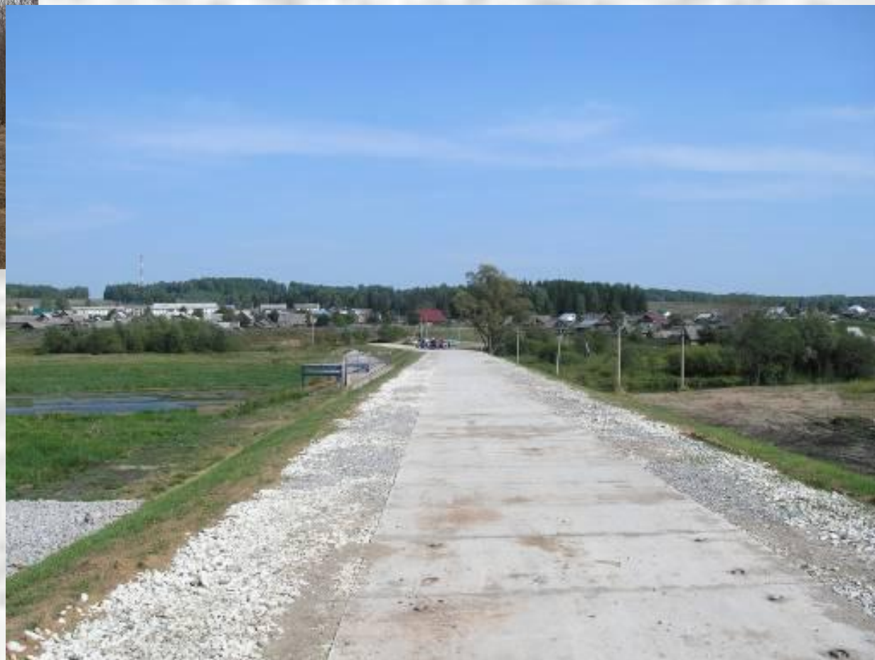
ГТС пруда на р.Поша в с. Уральское Чайковского района (до и после капитального ремонта)
