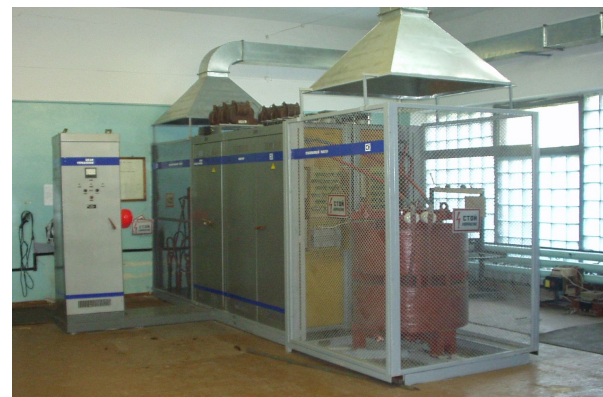
Тиристорный преобразователь частоты ПЧ–ТПП–200–10к– УХЛ4 Центральная насосная станция, г. Москва
