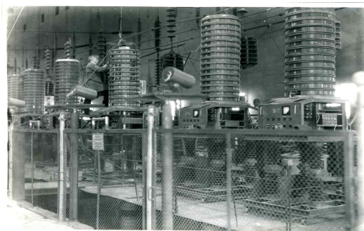
Передача постоянного тока Кашира–Москва 100 кВ, 150 А
