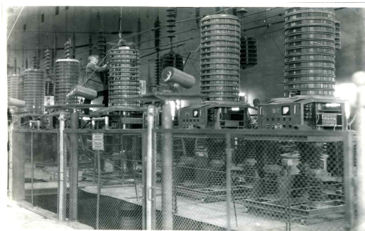
Передача постоянного тока Кашира–Москва 100 кВ, 150 А
