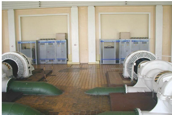
Тиристорный преобразователь частоты ПЧ–ТПП–200–6к–УХЛ4 Восточная станция водоподготовки, г. Москва
