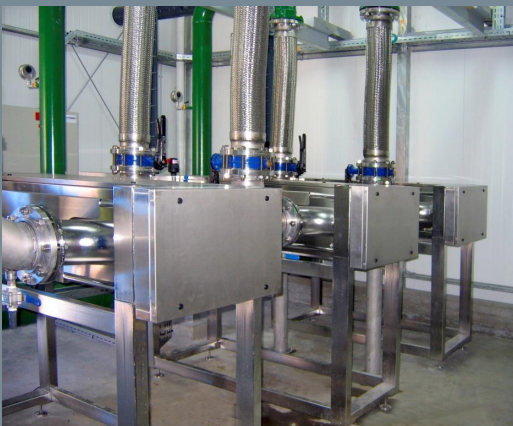
3 установки Atlantium по 100 м 3 /час
