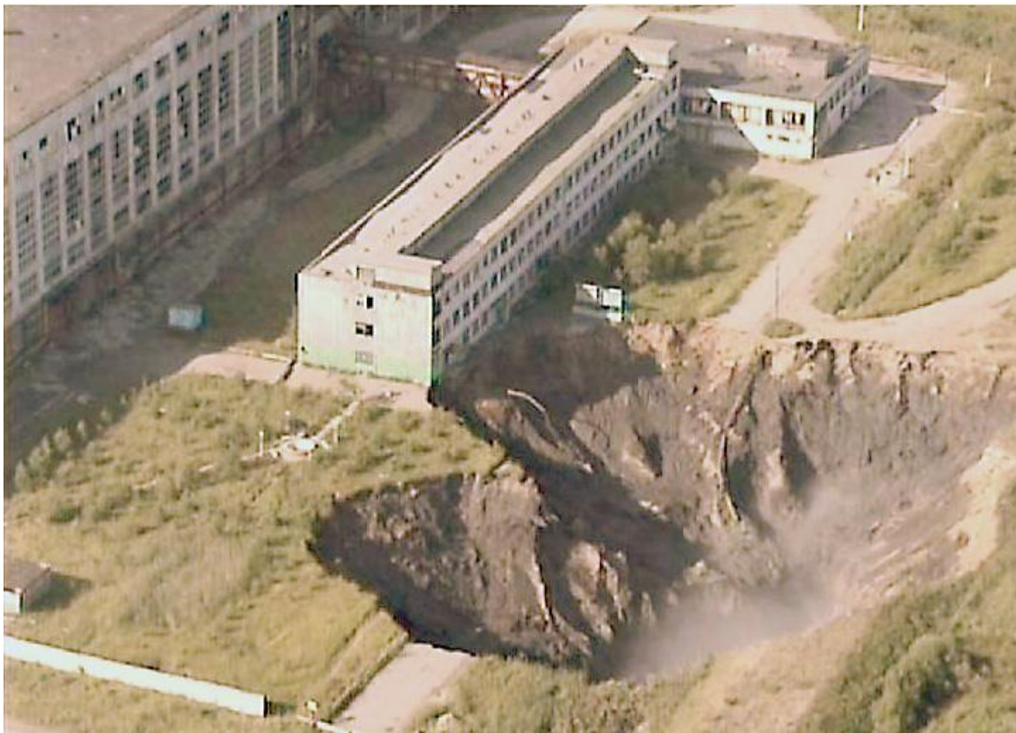
Провал на месте прорыва подземных вод в соляную шахту
