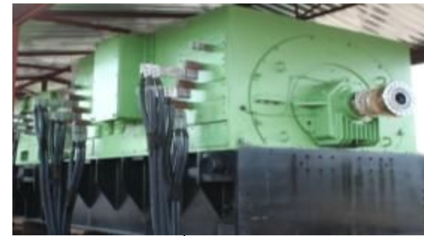
Электрогенераторы АТГ-7370/600-6000-У2 (Производитель ООО «Электротяжмаш-Привод»)
