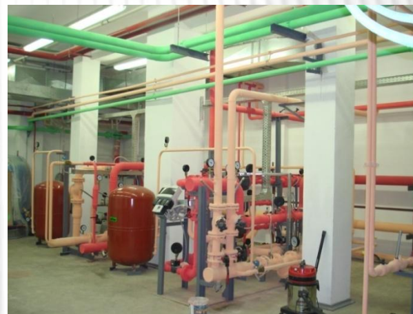
г. Красноярск БЦ «Европа» утепление трубопроводов
