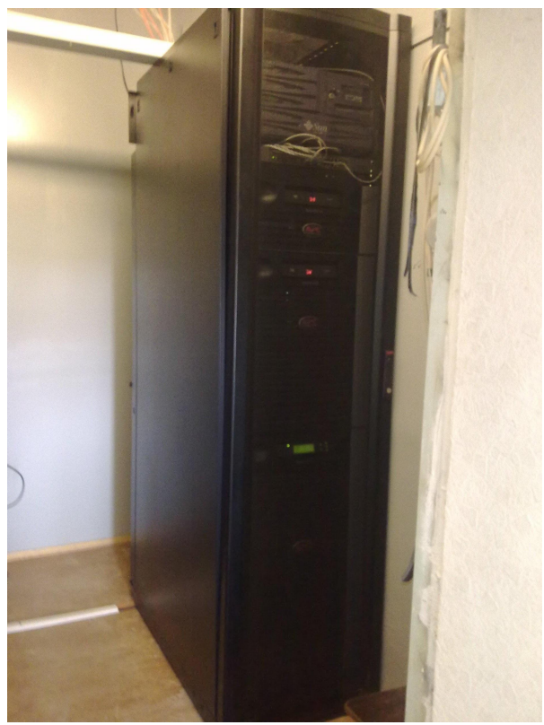
APC SIMMETRA LX16
