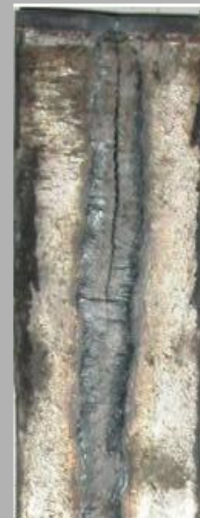
Дефекты сварного соединения
